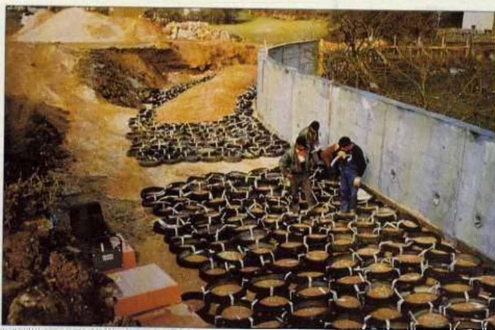
Fig. 4 - Réducteur de poussée derrière un mur de soutènement.
