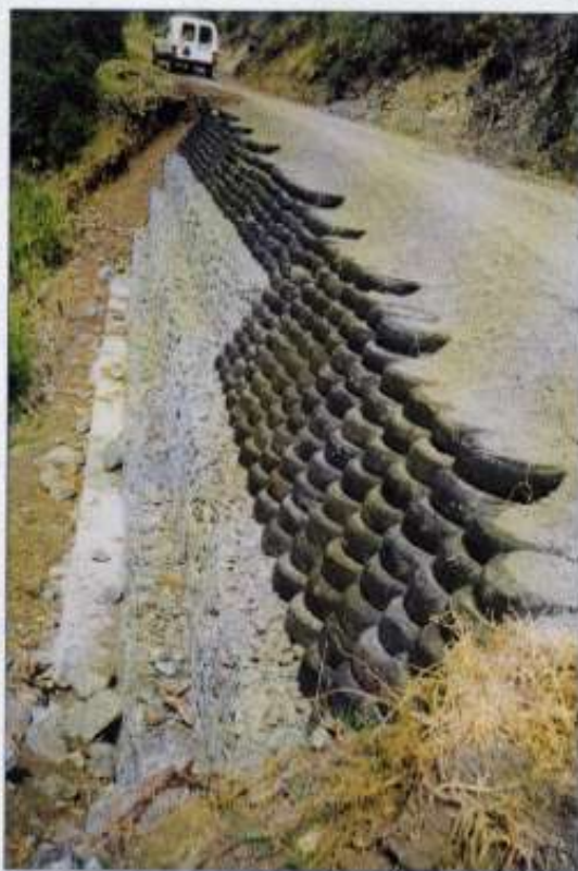
Renforcement de chaussée à la Roche Merveilleuse (Cilaos) - Ouvrage réalisé par l'ONF (1967)
